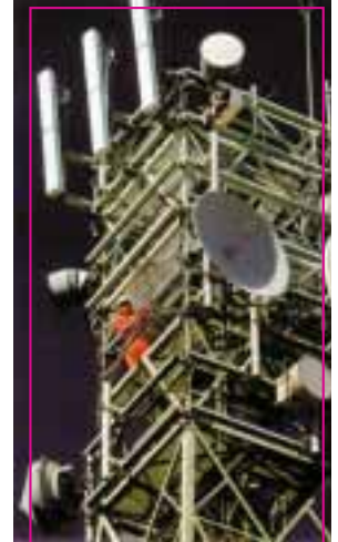
يرى في الصورة المحطة الرئيسية للتشغيل.
